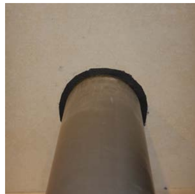
PVC leiding welke wordt dichtgeknepen in geval van brand.
